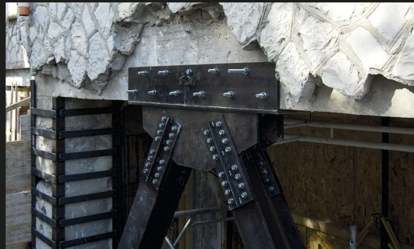
Controventi in acciaio
